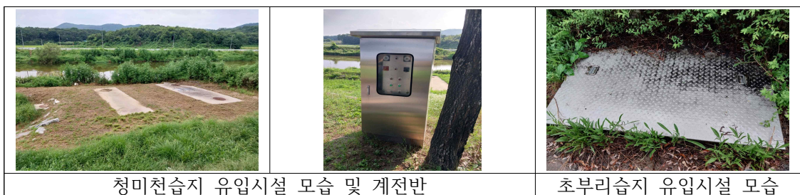
[표 93] 청미천습지 및 초부리습지 기계시설 전경
