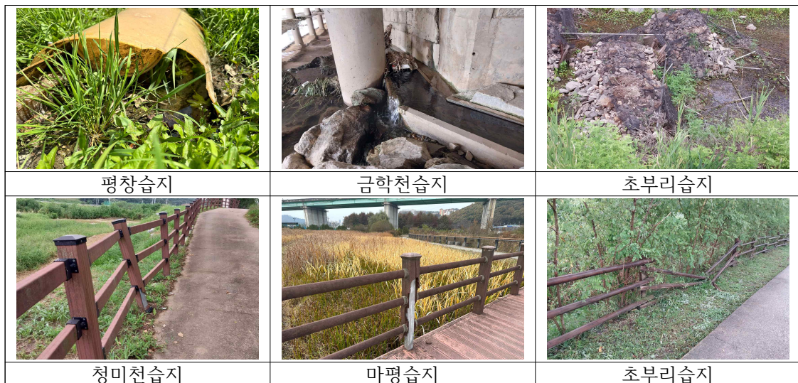
[표 92] 지점별 파손된 시설물 현황
